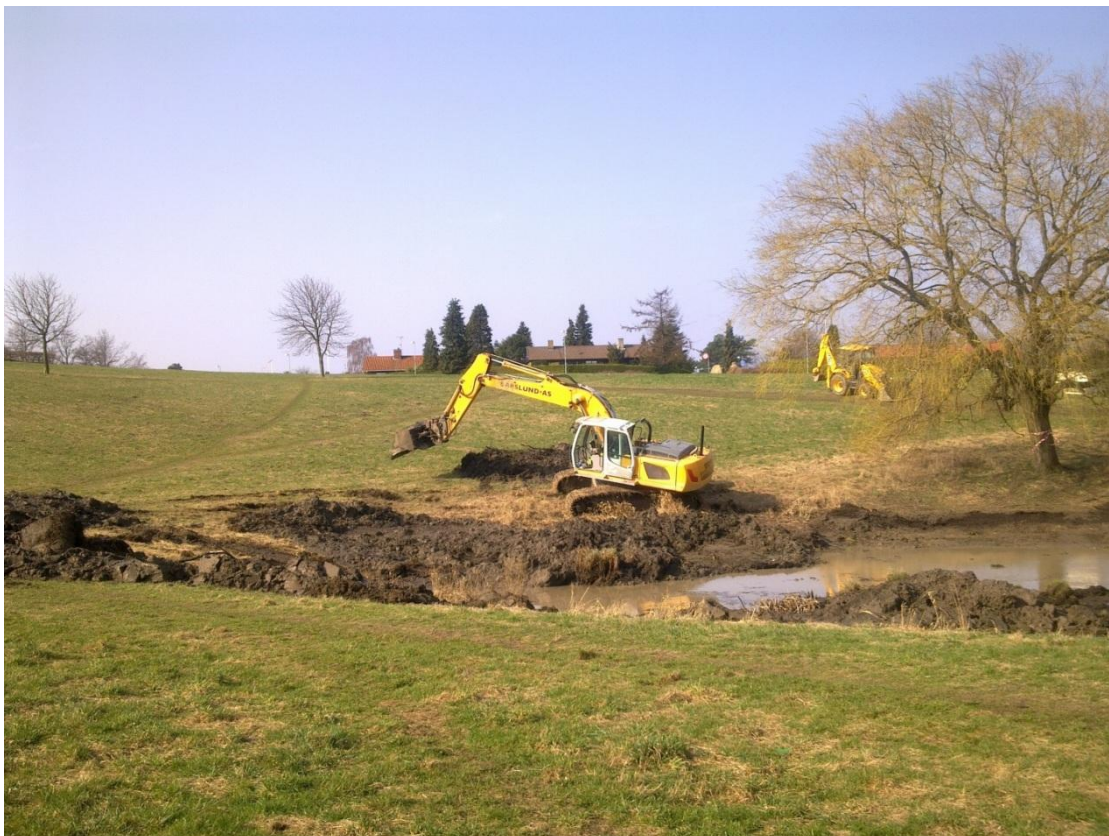
Bulldozerne går i aktion på fri-arealet ved Nattergalevej to år senere (Foto : Hørsholm Kommune – marts 2012)
