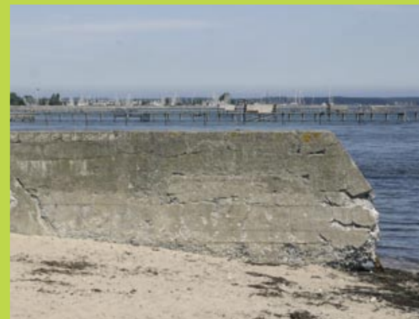
Betonmuren er en effektiv hindring for den vandrende.
